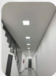
Forro em Drywall
